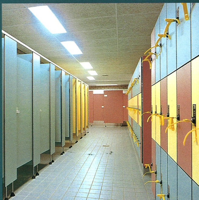
Cabinas para ducha, vestuarios y armarios.
